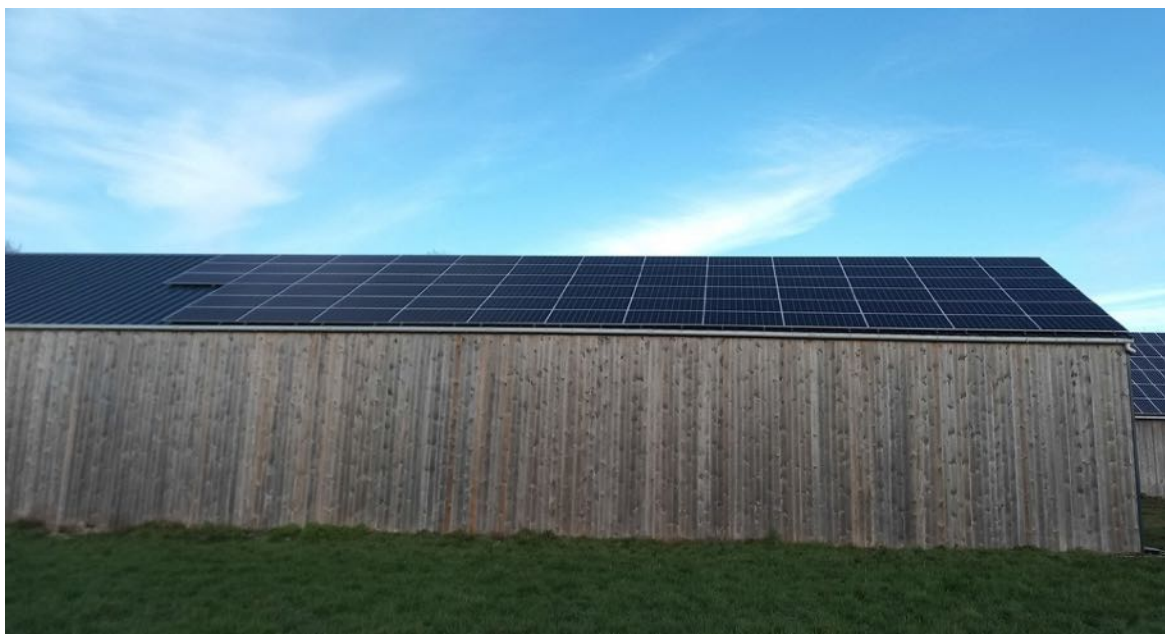
Les toits des bâtiments agricoles supportent les panneaux solaires de la centrale photovoltaïque de la ferme de Brandéha.
