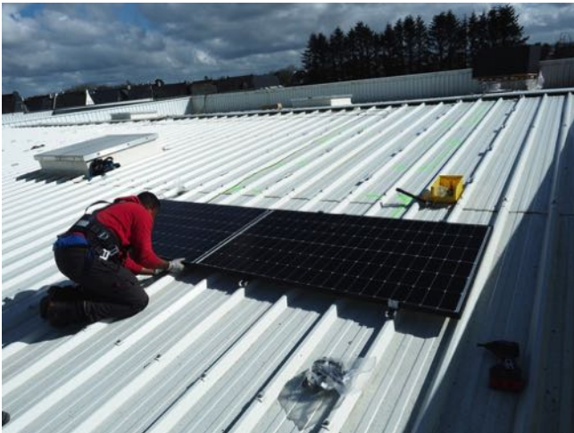
Pause des premiers panneaux solaires sur le toit des ateliers municipaux de Lannion.
